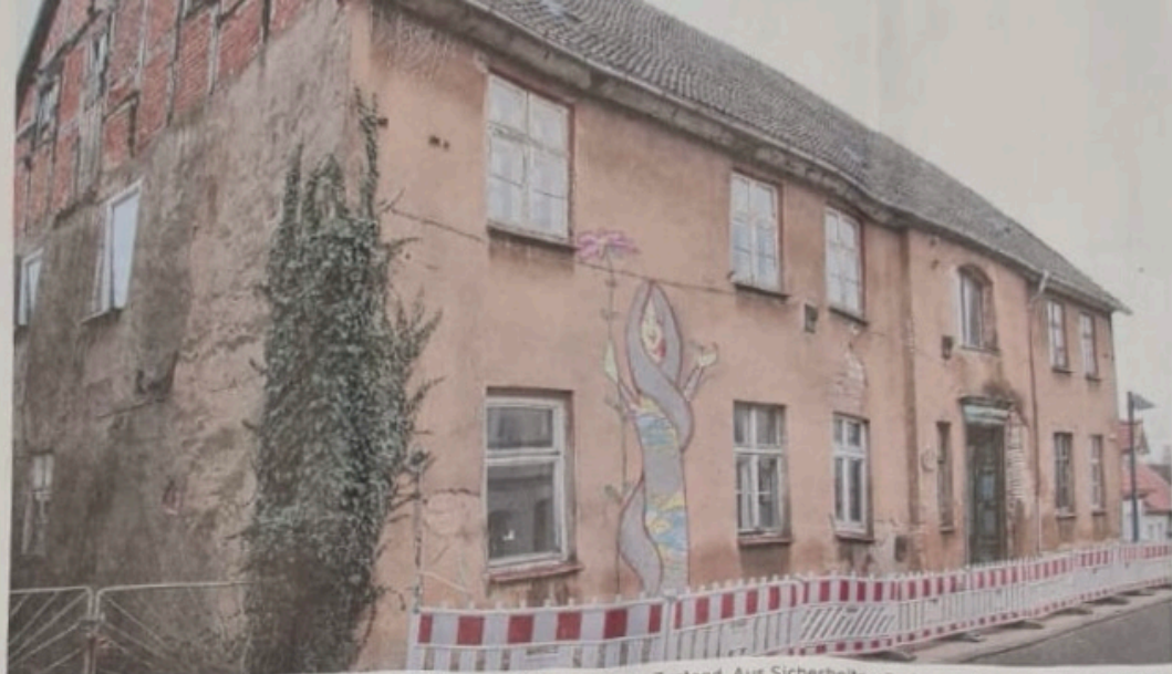
Das alte Zollhaus in der Peenestraße 35 ist baulich in einem sehr schlechten Zustand. Aus Sicherheitsgründen wurden bereits Warnbaken aufgestellt, damit Fußgänger nicht in Berührung mit losen Steilen kommen.
